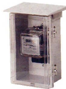
ใส่มิเตอร์ในตู้แบบฝาใสเห็นง่าย เชดเจน ไม่เป็นสนิม (ตรงบานพับก็ใช้สกรูทองเหลือง)
